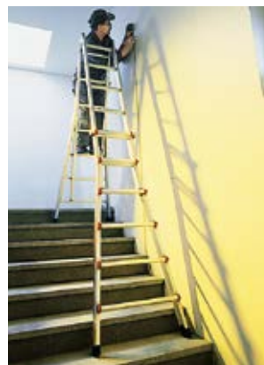
Giusto Sulle scale a gradini occorre usare scale a pioli con montanti regolabili.
